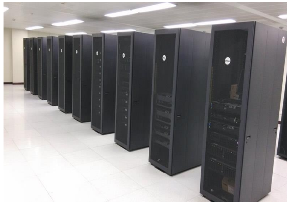
120平米专业化、电信级标准数据中心机房
